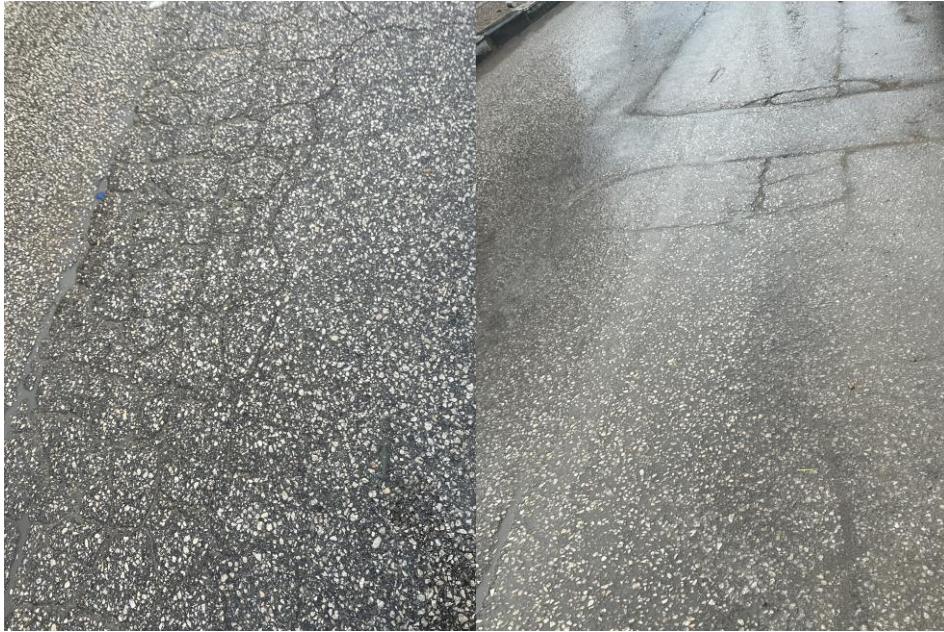
الشكل (3-5):- عيوب التشققات في الطريق
