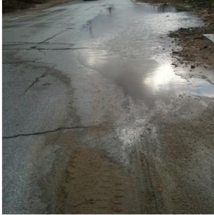
الشكل (3-18) تجمع مياه الامطار
