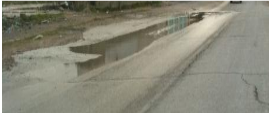
الشكل (3-19) تجمع مياه الامطار
