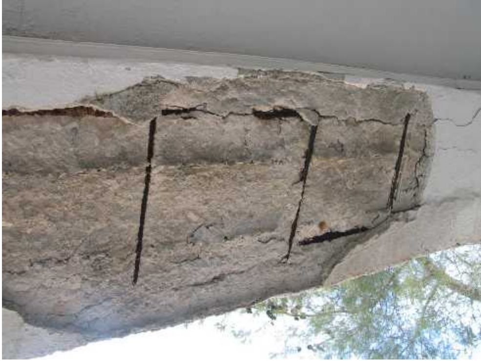
(أ -): جزء من المبنى المعرض للسقوط في مدرسة بيت الروش الفوقا
