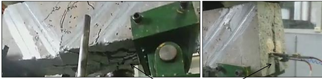
Fissures de séparation
