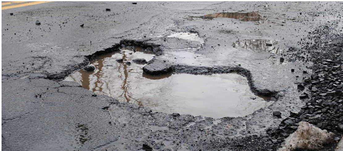
الشكل (3-3) : عدم وجود تصريف لمياه الامطار
