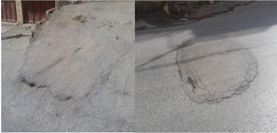
الشكل (3-6) : عيوب التشققات في الطريق
