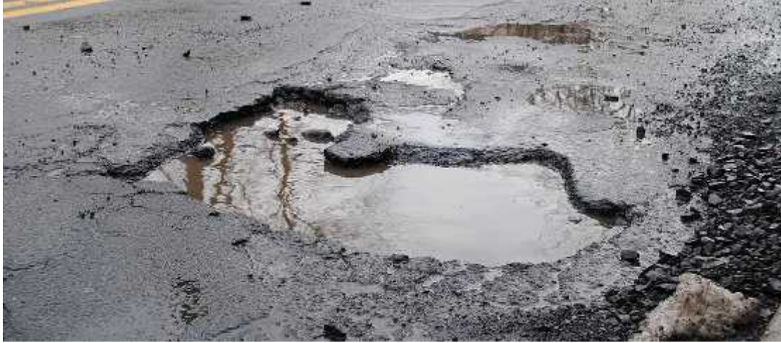
١٠٠٠ ( 3-١): عدم وجود تصريف لمياه الامطار
