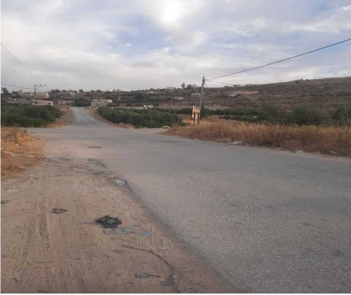
شكل (3-4) صورة توضح عدم وجود نظام تصريف الامطار
