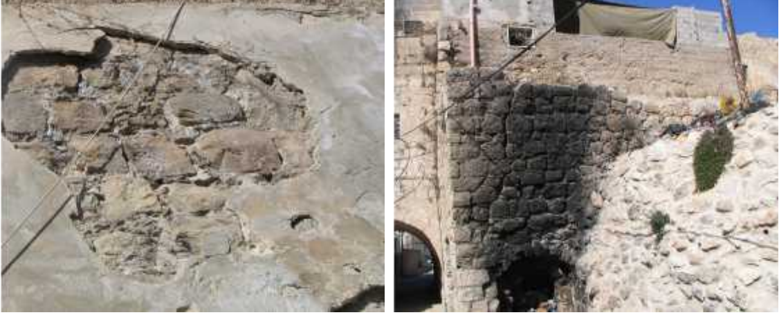
الشكل - : آثار الحريق والمادة الإسمنتية المضافة على الحجر الأصلي في الواجهة الخارجية
