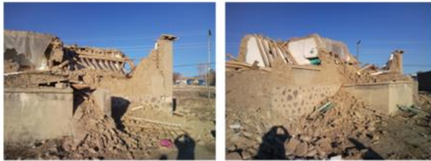
Figure 2.3: collapse masonry building. (Bayraktar, A., Altunışık, A.C. and Muvafık, M., 2016.) [3]
