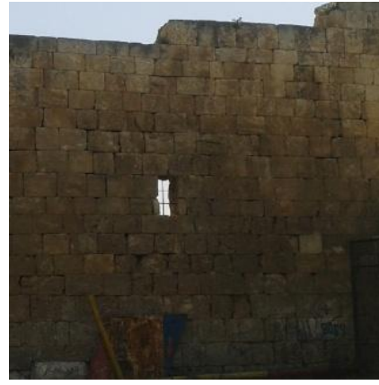
الشكل ( 5-41 ): صورة توضح الجدار الشمالي للمبنى الذي أصابه الشرخ .
