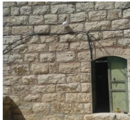
الشكل ( 5-25 ) : صورة توضح التمديدات الكهربائية
