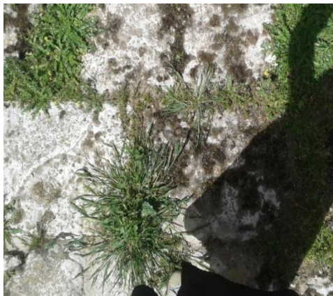
الشكل ( 5-44 ): صورة توضح العفن والطحالب في حجارة الواجهة .
