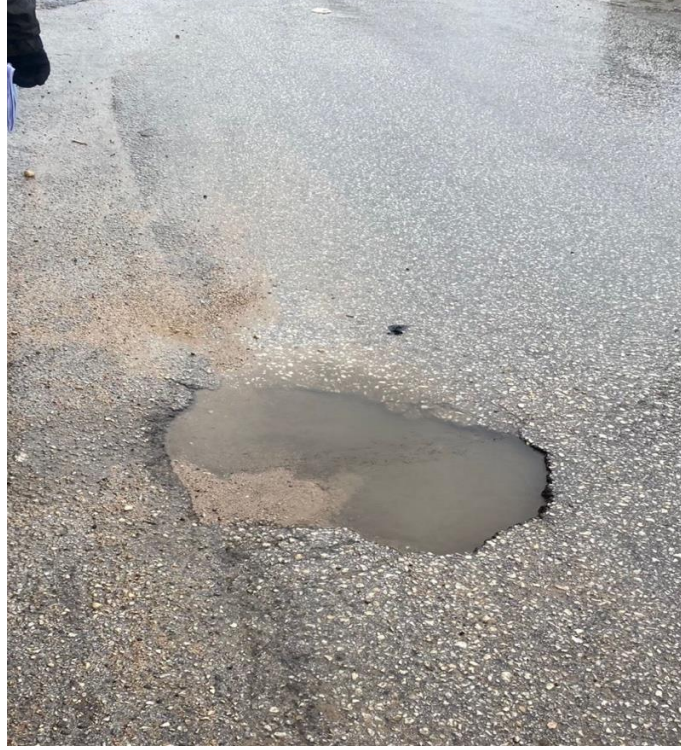
صورة (2-3) تبين سوء تصريف مياه الأمطار
