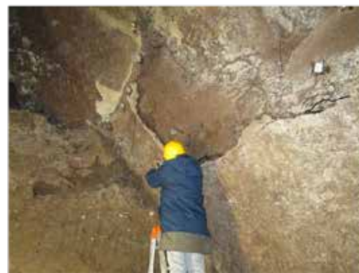
Estesi distacchi degli intonaci prodotti dall'infiltrazione delle radici
