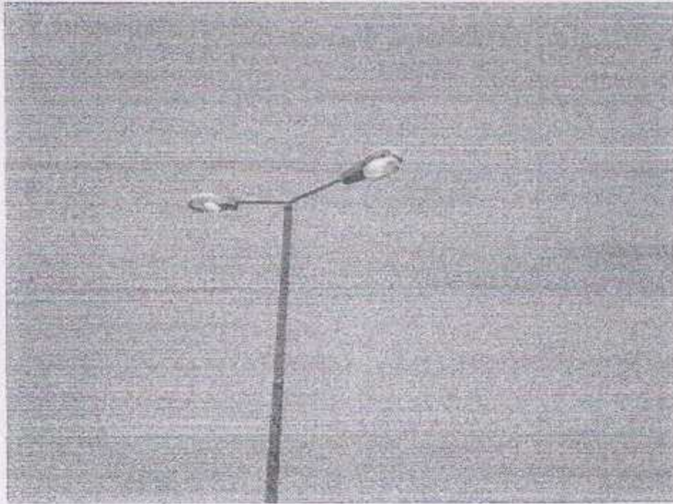
الشكل (٣-٢٥) إضاءة الطريق.
