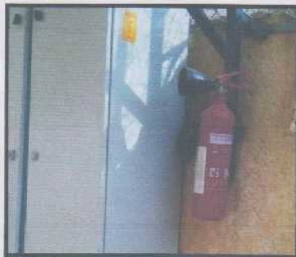
الشكل (٣٢.٤) طفايات الحريق في ساحة مبنى جمعية بيت القديس نقولاوس الخيرية للمسنين المصدر: البحث، ٢٠١٣
