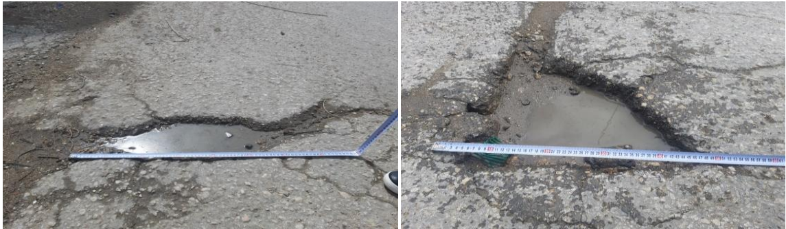
الشكل ( 3-7 ) : يوضح وجود حفر في الطريق
