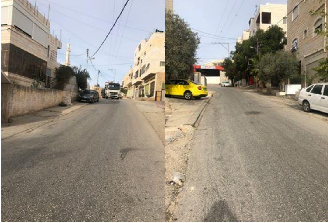
صورة رقم (3-1) مشاكل الطريق
