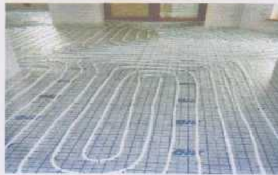
شكل (٢١-٥) سخانات لتأابيب المياه تحت البلاط المصدر: (سلطة الطاقة الفلسطينية، ٢٠١٤-١٢-٣)
