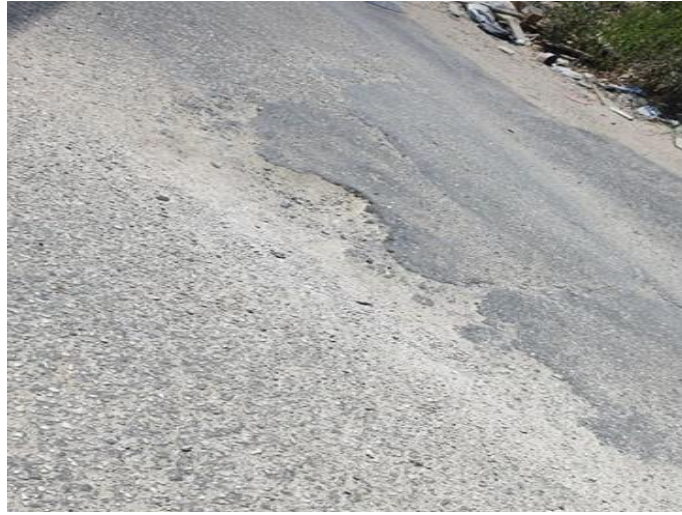
شكل (3-5) توضح الحفر الموجودة في الطريق
