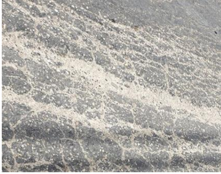
شكل (4-5): عيوب التشققات في الطريق
