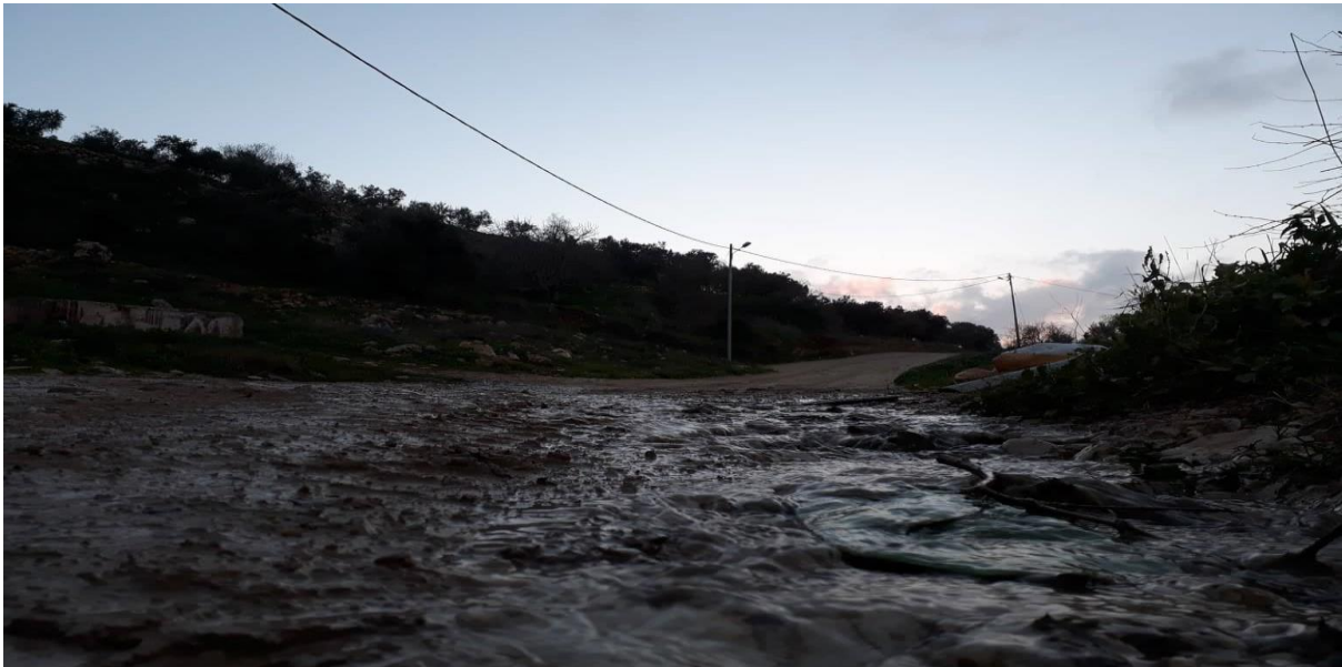
الشكل ( 5-3 ) يوضح تجمع المياه في الطريق وسوء تصريف المياه .
