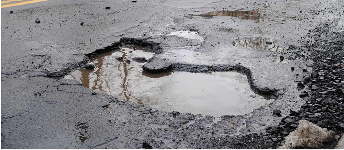
الشكل (1-3) : عدم وجود تصريف لمياه الامطار
