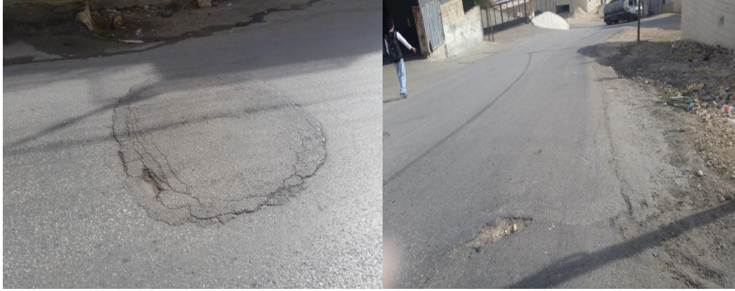
الشكل (3-4) : عيوب التشققات في الطريق
