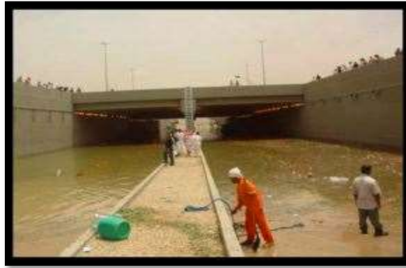
الشكل ٤-١٤: عدم القدرة على تصريف مياه الأمطار. [14]
