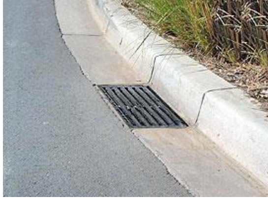
الشكل (٧-٢) : gutter inlet
