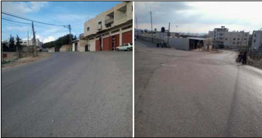
رع عن الطريق الرئيسي وسوء تصريف مياه الأمطار فيه ( - )
