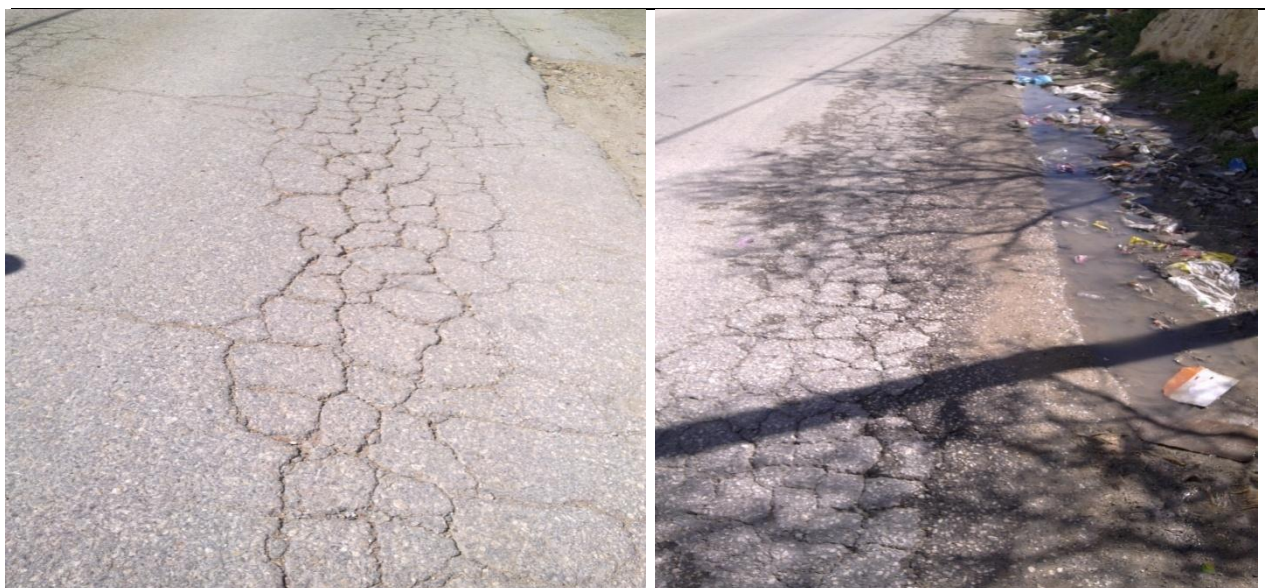
الشكل (2-3) عيوب التشققات في الطريق ( 2/10/2011)
