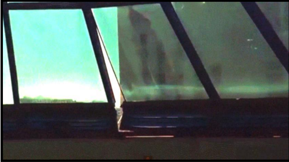
شكل (٥.٦): صورة تبيّن أضرار القبة بعد المنخفض. المصدر: ( http://www.youtube.com )
