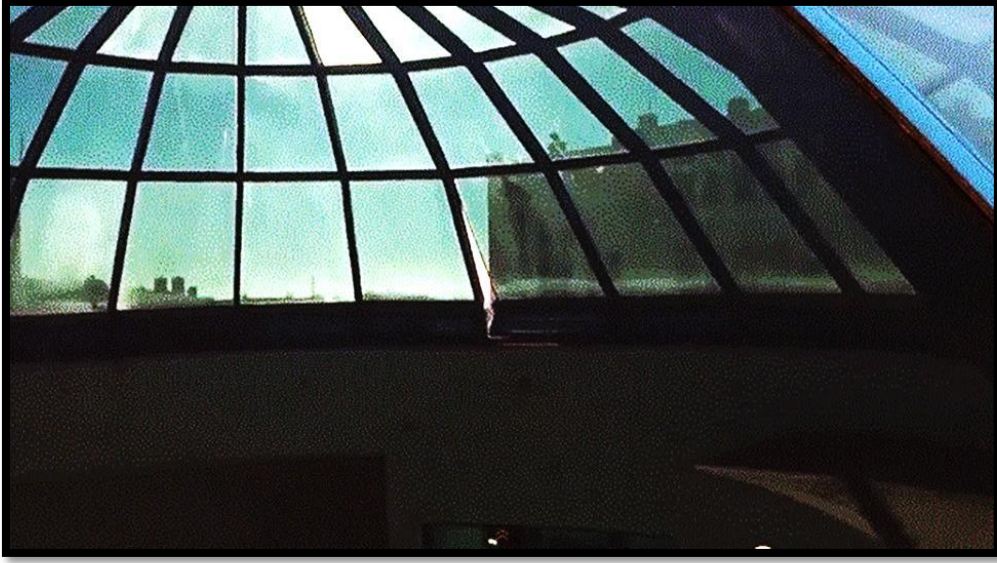
شكل (٤.٦) صورة تبيّن أضرار القبة بعد المنخفض. المصدر: ( http://www.youtube.com )
