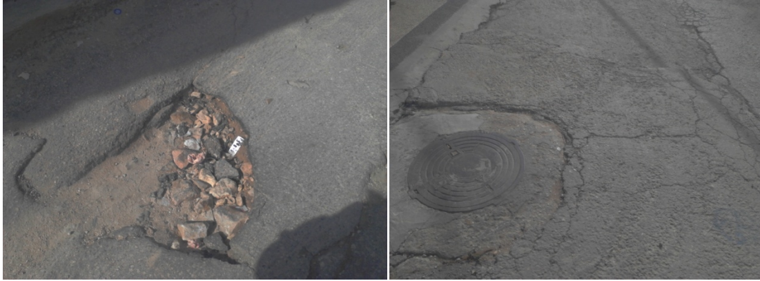
الشكل ( - ) عيوب التشققات في الطريق ( / / )
