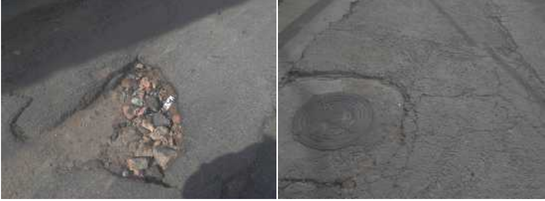
الشكل ( - ) عيوب التشققات في الطريق ( / / )
