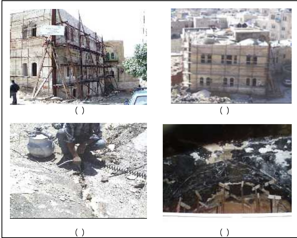
الشكل ( - ) : أعمال ترميم قصر الدويك. ( ) ( ) تدعيم الواجهات الخارجية للقصر. ( ) تدعيم الفراغات الداخلية بالجكات والطوبار. ( ) حفر الشقوق بالمونة الجيرية. المصدر: لجنة إعمار الخليل.
