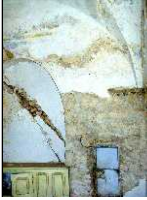
الشكل ( - ) : شقوق في جدران القصر. المصدر: لجنة إعمار الخليل.
