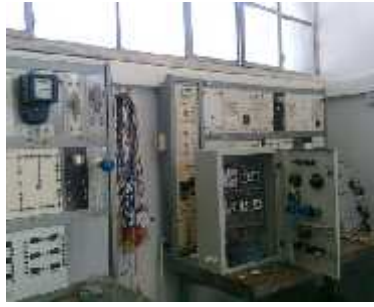
( - ) قسم كهرباء استعمال
