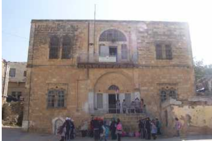
-الخليل- ( - - )الواجهة الخلفية لمدرسة أم عمار الابتدائية للبنات الواقعة في شارع فلسطين.أخذت بتاريخ - - .فريق العمل.
