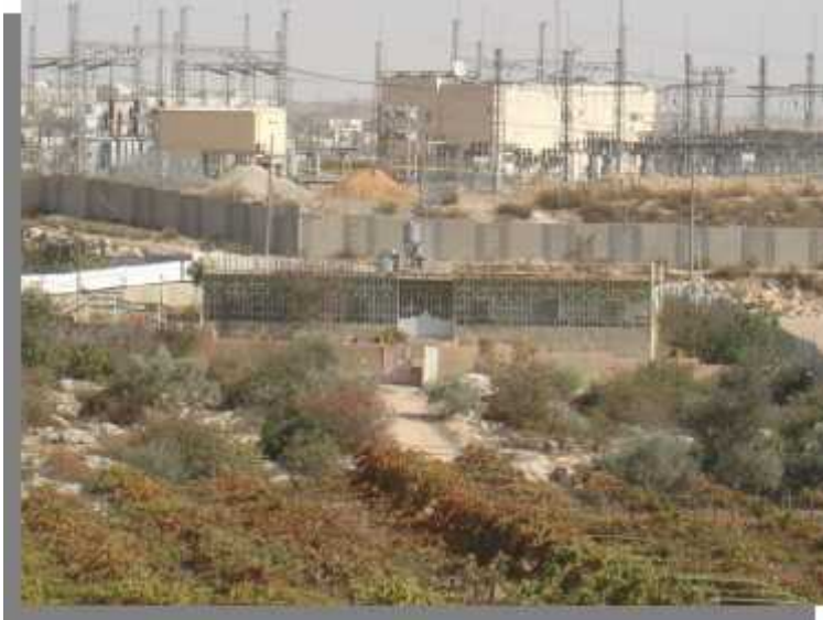
صورة (٣-٤) المحول الكهربائي، يقع في الاتجاه الشرقي من أرض رابطة الجامعيين، منطقة نمره، فريق البحث. (فريق العمل)
