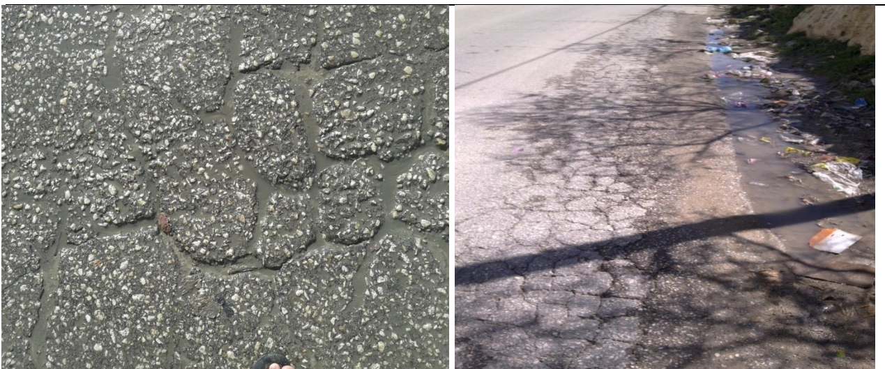
الشكل (3-4) عيوب التشققات في الطريق
