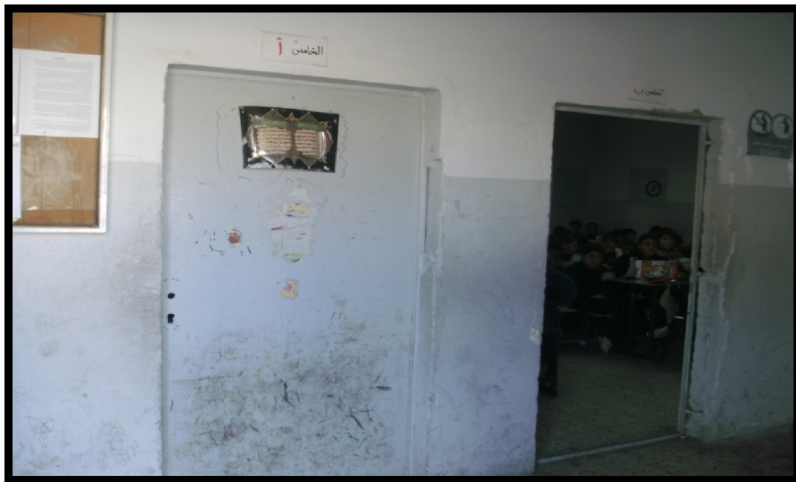
الصورة (٢١-٢): الصورة مأخوذة من موزع المبنى ٢ يظهر فيها مداخل غرفتين صفيتين .
