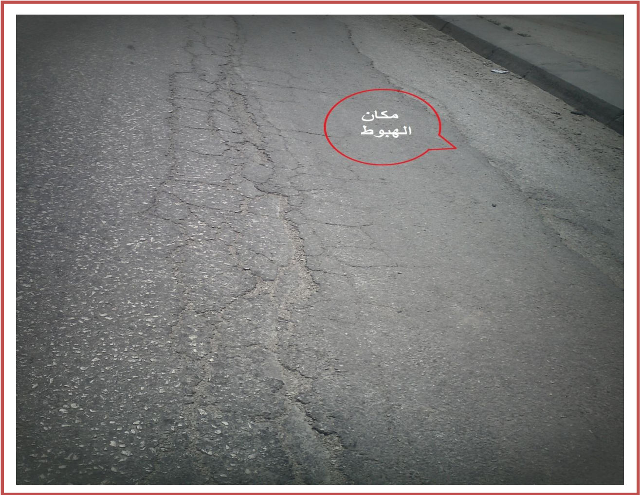
الشكل (٤-٨): مشكلة الهبوط في الشارع
