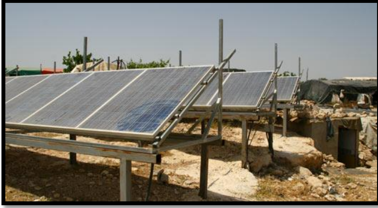
الصورة (3. 6) :الالواح الشمسية التي وضعتها منظمة "كومط" والتي توفر الكهرباء لسكان خربة سوسيا، التي ترفض اسرائيل ان تربطها بشبكات الكهرباء والمياه. تصوير: شارون عزران، بتسيلم
